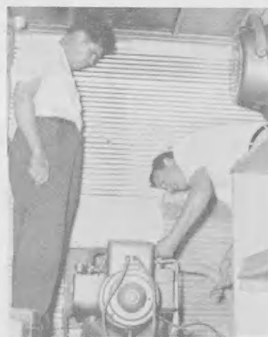
THIS GASOLINE engine furnishes the unit's 110 volt power. E MOTOR di gasoline aki ta duna coriente di 110 volt.
